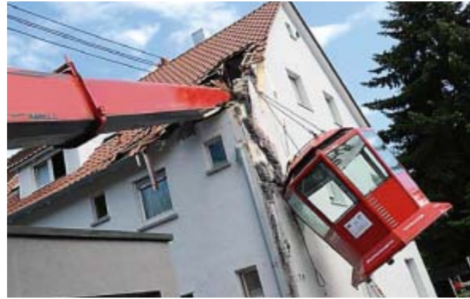
Einschlag: Es gab bereits Unglücksfälle – hier stürzte der Mobilkran wegen einer Abstützung auf schlechtem Untergrund mitsamt der angehängten Personengondel um. Es gab Verletzte und reichlich Sachschaden. (Bild: NWZ)
