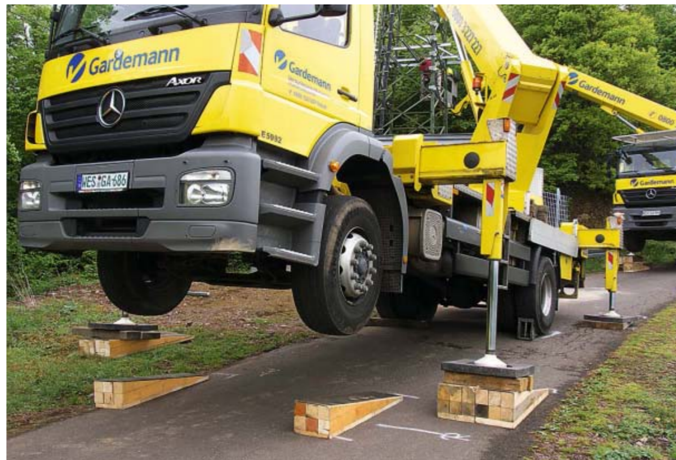
Auf der schiefen Bahn: Eine Hubarbeitsbühne auf geneigter Fläche sicher aufzubauen, erfordert besondere Maßnahmen – auch wenn die Schräge nicht ganz so spektakulär ist. Auf jeden Fall sollen die Hinterräder bergauf stehen und von Vorlegekeilen gesichert werden.
