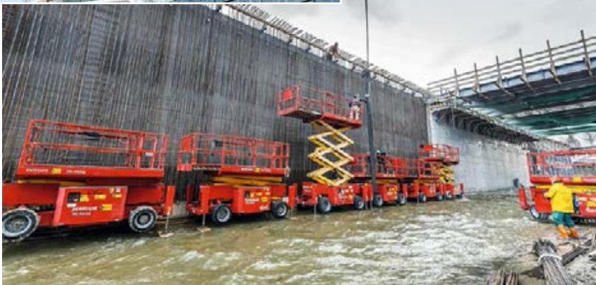
◀ Füße im Wasser: Als nützliche Helfer beim Bau einer 2.000 Quadratmeter großen und 8,5 Meter hohen Plattform aus Stahlbeton erweisen sich sieben Scherenbühnen aus der Mietflotte von Zeppelin Rental. Wegen der beengten Platzverhältnisse im Zuge des U-Bahn-Baus in der Wiener Innenstadt wird die Plattform zur Lagerung von Baumaterialien, Containern und Geräten benötigt. Die Scherenbühnen wurden dabei unmittelbar im Flussbett der Wien positioniert – die Stützen im Wasser, die Räder knapp über die Wasseroberfläche angehoben. (Bild: Zeppelin Rental)
