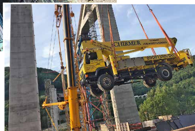
▲ Flugbühne: Die fast 500 m lange, zweigleisige Filstalbrücke im Zuge der Neubaustrecke Wendlingen-Ulm verbindet am Aufstieg zur schwäbischen Alb zwei Tunnel unmittelbar miteinander, und wird mit 85 m Höhe über Grund die dritthöchste Bahnbrücke Deutschlands sein. Für die Arbeiten am zweiten Überbau in Gegenrichtung musste die Lkw-Bühne von Schirmer (Ulm) umgesetzt werden – der Mobilteleskopkran nahm dazu die 18 t schwere Bühne einfach an den Haken. (Bild: Schirmer)
