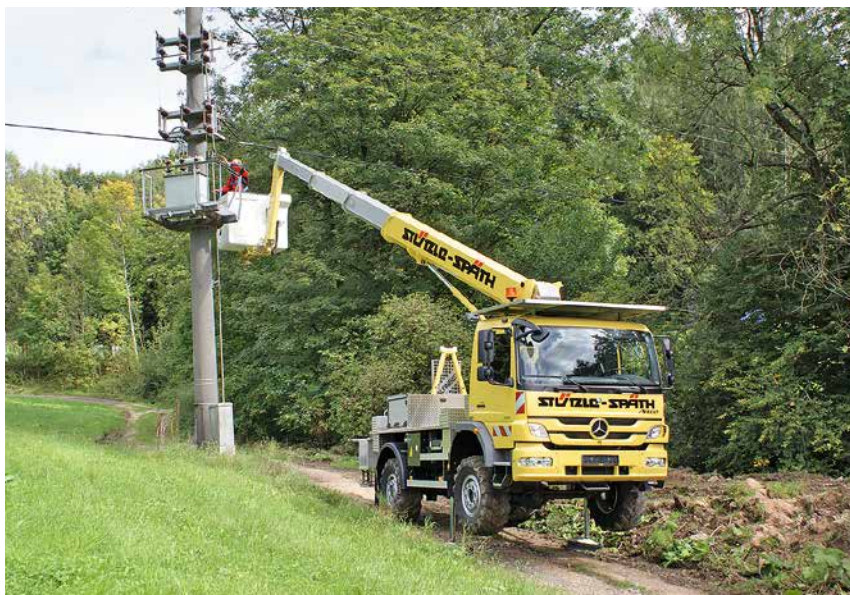
Funkenstrecke: Nicht nur der Kontakt mit einer Stromleitung kann tödlich sein, hohe Spannungen können überschlagen. Die Profis, die hier arbeiten, sind speziell dafür ausgebildet und verwenden isolierte Arbeitskörbe. (Bild: Palfinger)
